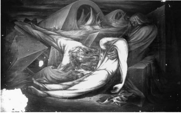
El mural principal, Masacre , en el muro sur-sureste del salón. Se aprecian las pérdidas de pintura por el deterioro del muro.
